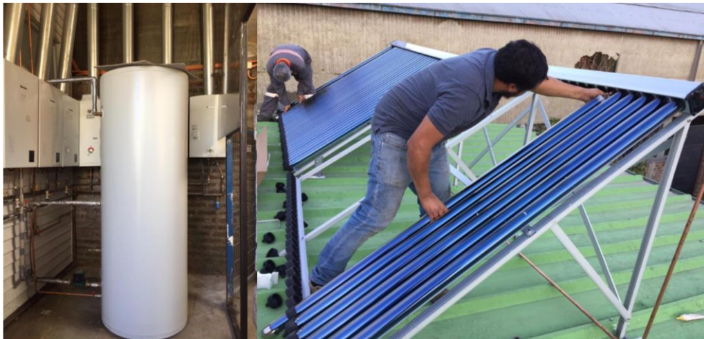
Incorporación equipos de eficiencia hídrica y energética
