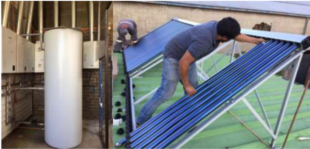
Incorporación equipos de eficiencia hídrica y energética
