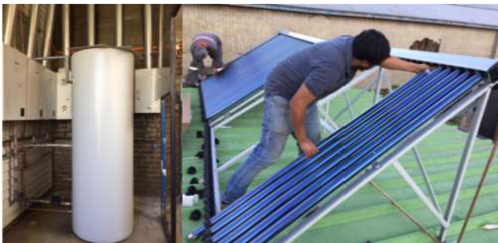
Incorporación equipos de eficiencia hídrica y energética
