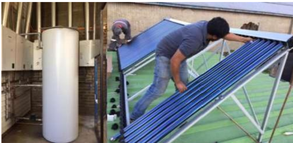
Incorporación equipos de eficiencia hídrica y energética
